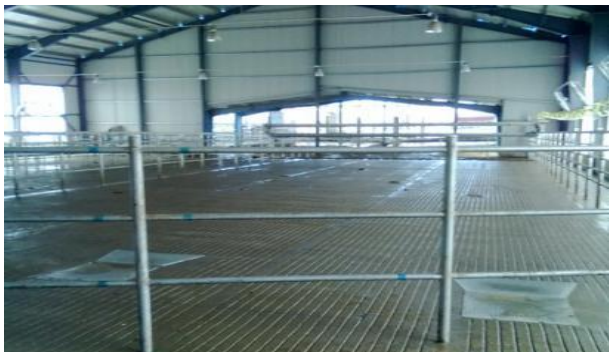
挤奶厅循环水冲洗系统
